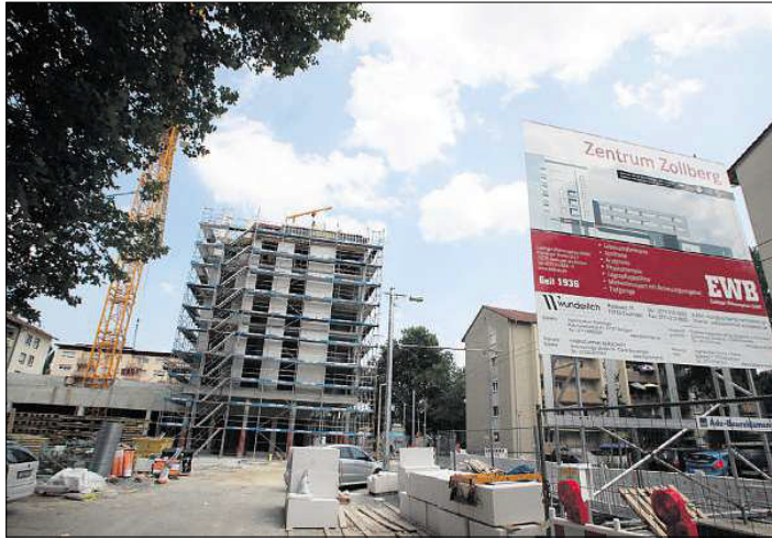
Investition in die Infrastruktur: Die EWB fühlt sich im Interesse ihrer Mieter auch für das Wohnumfeld zuständig. Aus diesem Grund engagiert sie sich auf Zollberg mit dem Bau eines Stadtteilzentrums. Foto: Rudel
