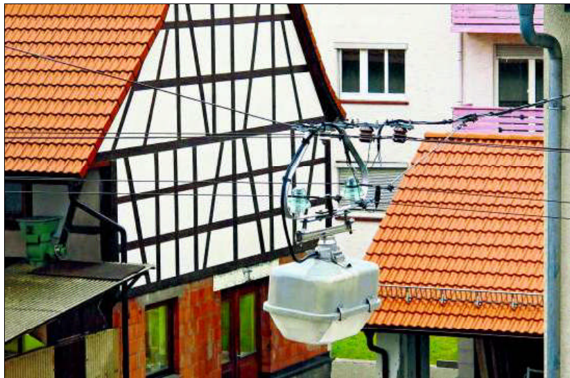
Noch bis Ende 2012 betreibt die EnBW die Stromnetze in Leinfelden-Echterdingen, wie etwa für die Stadtbeleuchtung. Foto: Malte Klein
